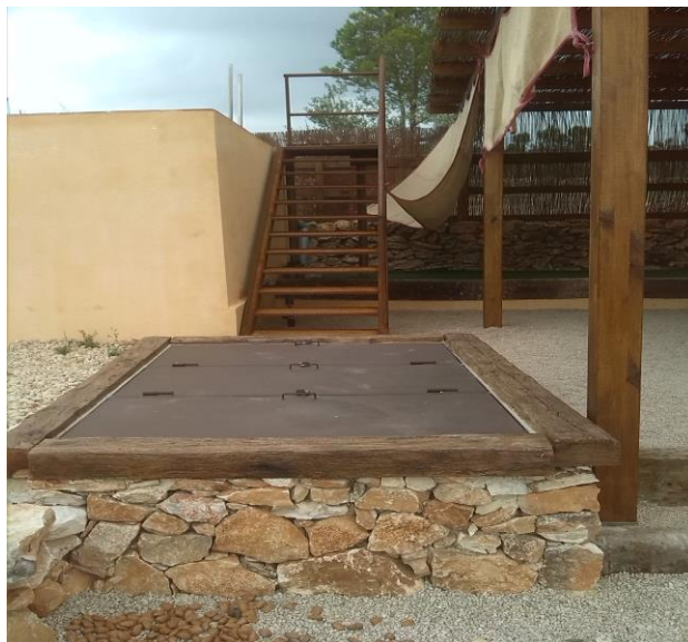
Arqueta filtre, aljub i grup de pressió
